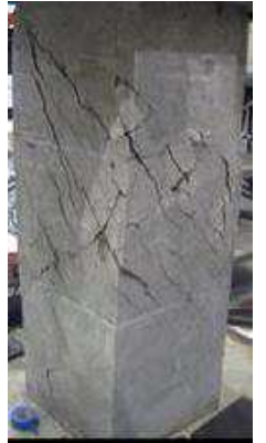
Kolonda burulma çatlakları
